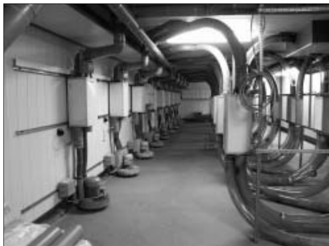
Centrála potrubní pošty v suterénu budovy Dětské kliniky.
