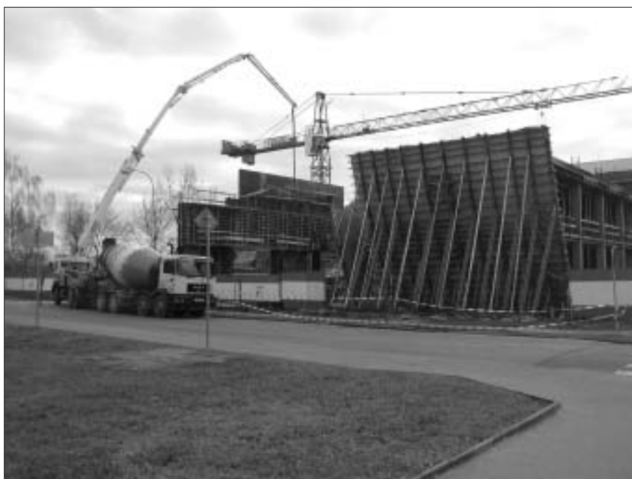
Výstavba v areálu Fakultní nemocnice Hradec Králové pokračuje. Na fotografii Ing. Jiřího Bobra je zachycena betonáž obvodových stěn Výukového centra LF UK.
