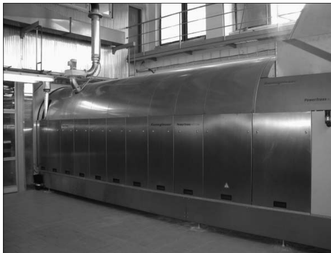
Část tělesa pračky Power Trans.
