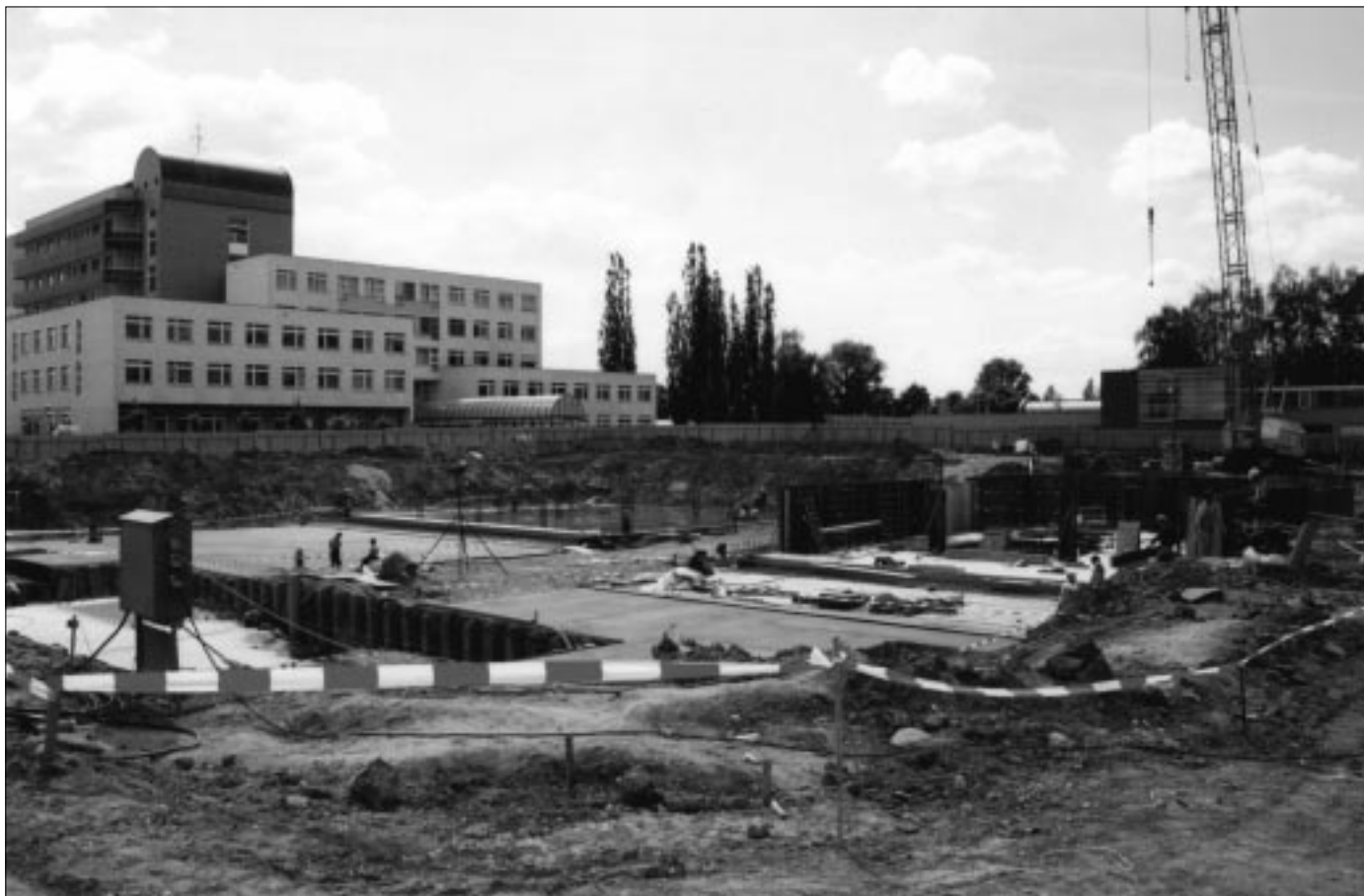
Budoucí centrum akutní medicíny FN HK s rodícími se základy nového pavilonu interních oborů.
